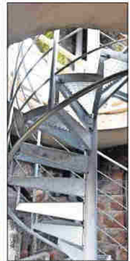
Möglich macht den Aufstieg zur Bismarckturm-Plattform die neue Wendeltreppe. Die alte hatte Rost angesetzt.
